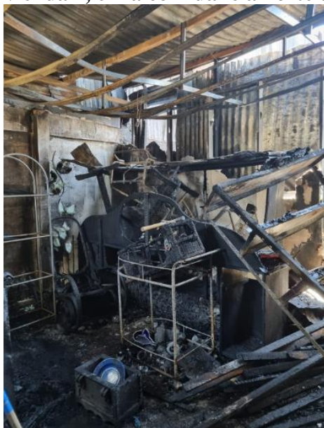
Foto 2: Afectación vivienda 7, en la colindancia norte de la vivienda 1, 2 y 3
