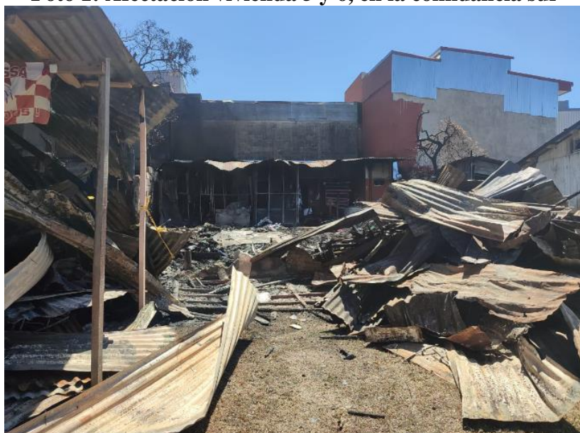
Foto 1: Afectación vivienda 5 y 6, en la colindancia sur
