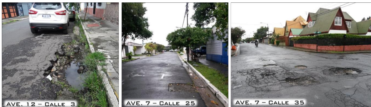
Figura 34. Superficie de ruedo en mal estado.
